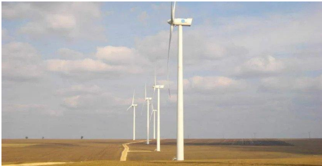
Το αιολικό πάρκο του Σουβόροβο. Πηγή: balkangreenenergynews.com
